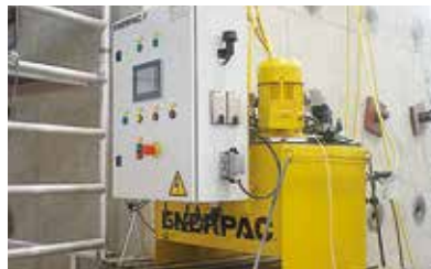
▲ Kundenspezifische Pumpen mit Steuerungspaketen.
